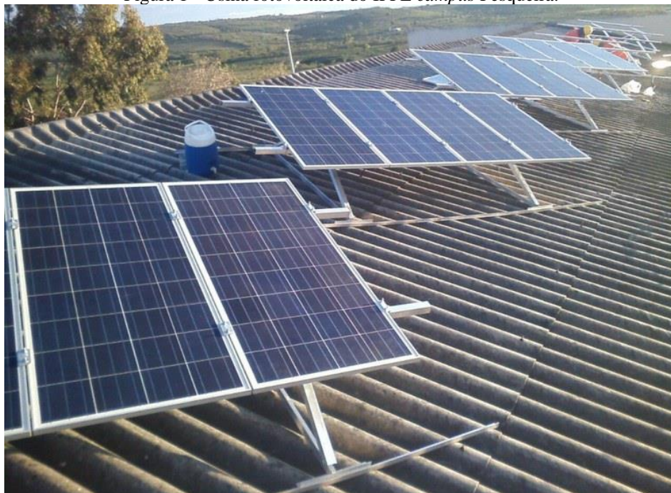
Figura 1 - Usina fotovoltaica do IFPE campus Pesqueira.
