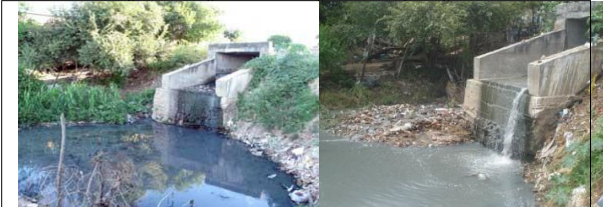
Figura 2 – Rio Jaguaribe recebendo esgotos no Município de Iguatu – CE.
