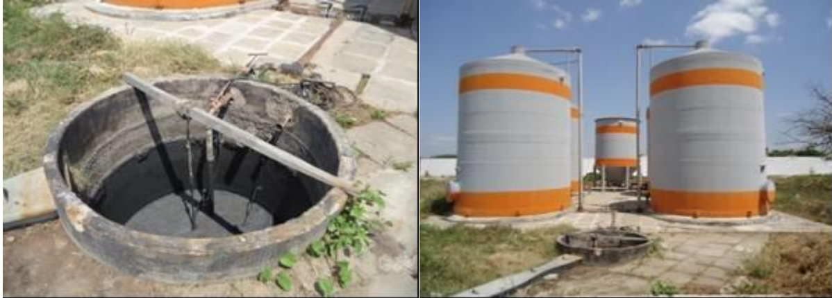
Figura 4 - Sistemas de recebimento de esgoto bruto (esquerda) e filtragem e tratamento (direita).
