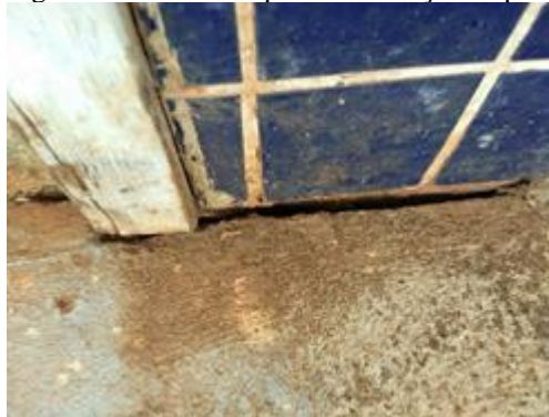
Imagem 4 – Fissura no piso entre calçada e parede
