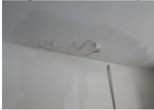
Imagem 9 – Manchas de umidade na laje
