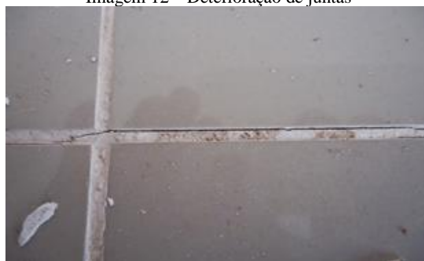
Imagem 12 – Deterioração de juntas
