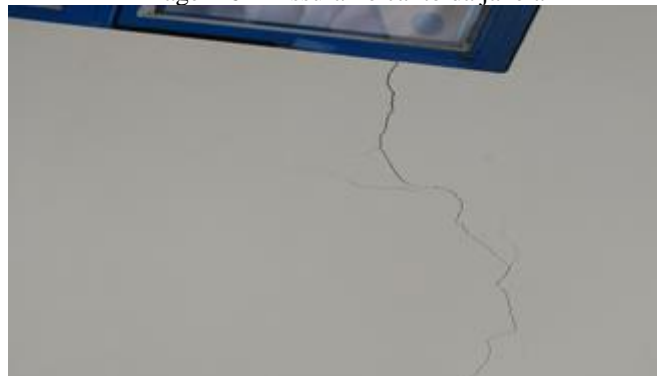
Imagem 6 – Fissura no canto da janela
