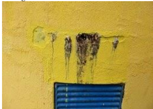
Imagem 5 – Fissura na lateral do reservatório
