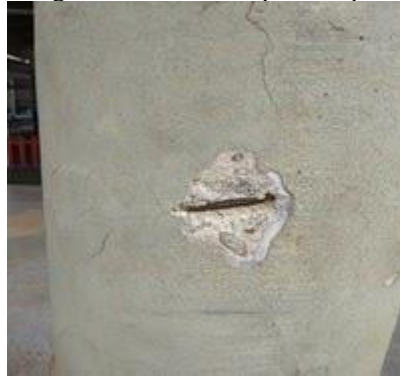
Imagem 7 – Fissura no pilar do pátio
