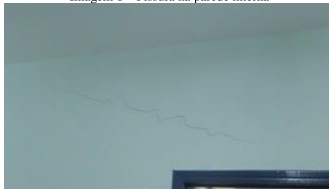
Imagem 8 – Fissura na parede interna
