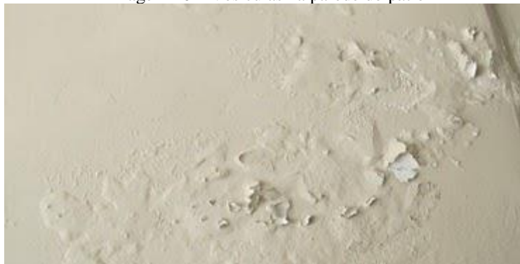
Imagem 10 – Vesículas na parede do pátio
