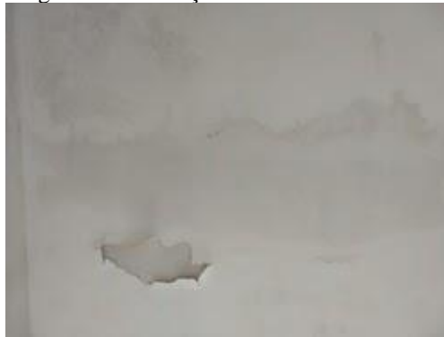
Figura 3 – Infiltração no teto hall de entrada
