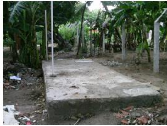
Figura 02: Tanque séptico secundários com volume aproximadamente 12m 3
