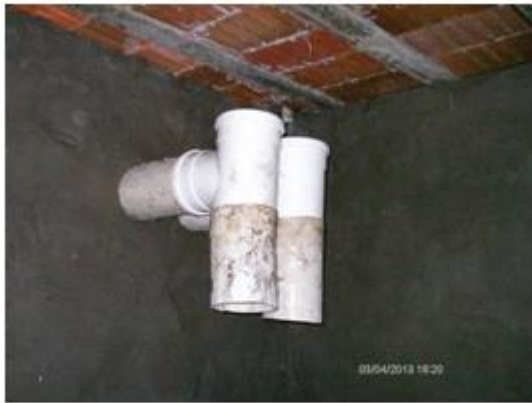
Figura 03: Tanque séptico principal, entrada inicial dos dejetos.
