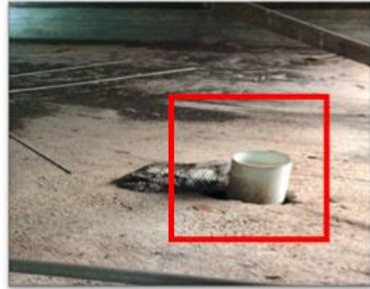
Figura 05: situação do tubo de queda.
