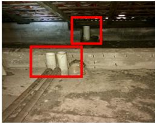
Figura 04: situação do tubo de queda.
